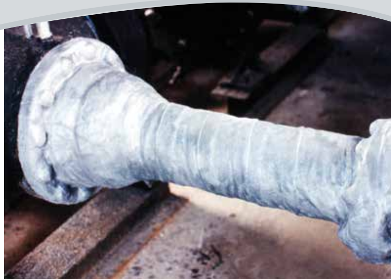
Una tubería que suda es protegida con Wax-Tape® #2 demostrando la capacidad de protección en condiciones de humedad.
